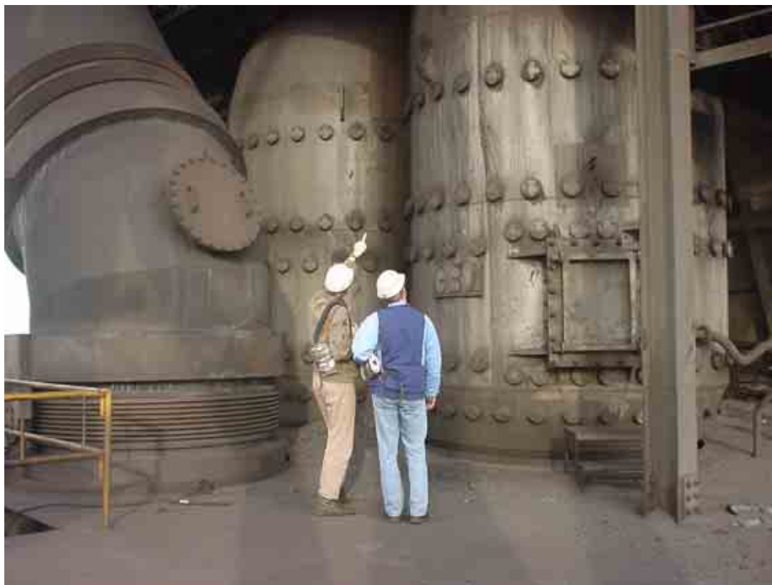
Gichtbunker/ Шихтовой бункер
